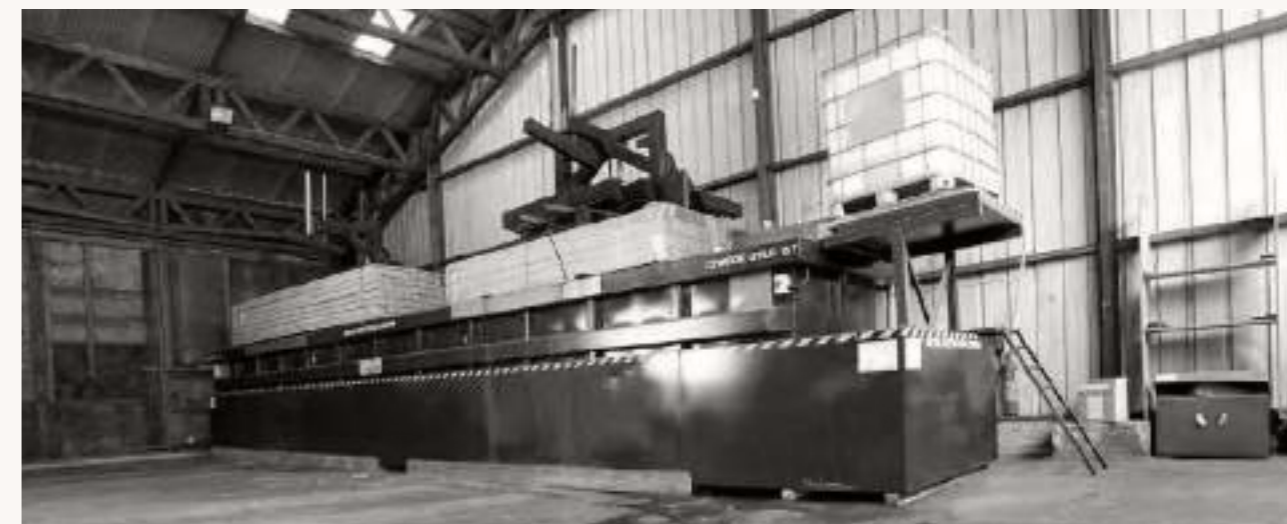
Bac de préservation Classe 2 - Site de Bouguenais (44)
